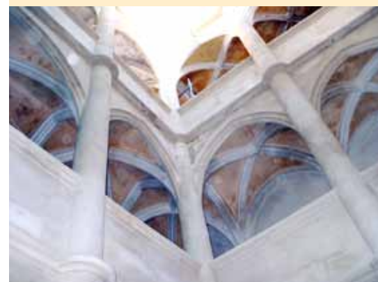
↑ La maison gothique accueillera bientôt le CIAP de Beaucaire. Vue de la loggia depuis la cour intérieure.
