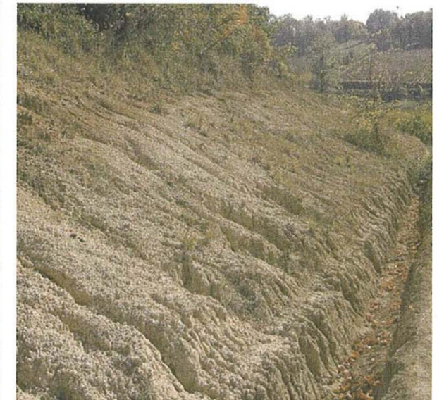
Erosion des talus
