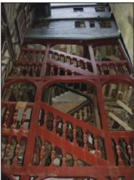
Escalier à volées droites, à galerie, ouvert sur cour, XVI ème , 22 rue Saint-Georges
